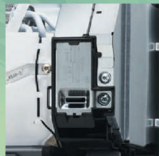
รับประกันการใช้งานที่วางใจได้ และการป้องกันอุบัติเหตุไฟไหม้ ในกรณีไฟฟ้าวัดวงจร
